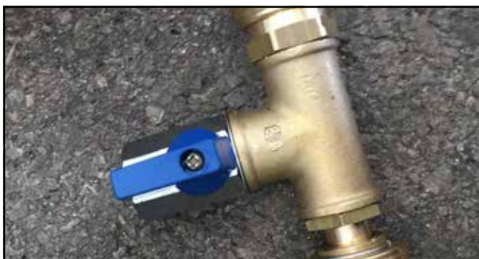
Slika 22: Ventil za praznjenje je odprt
